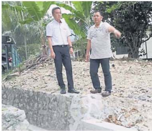
黎濂禧 (左) 视察工业区新建的沟渠无法排水。
